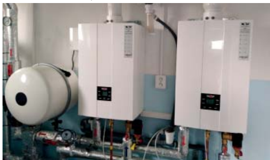
Nová kotelna zajišťuje vytápění objektu ČSZ.
